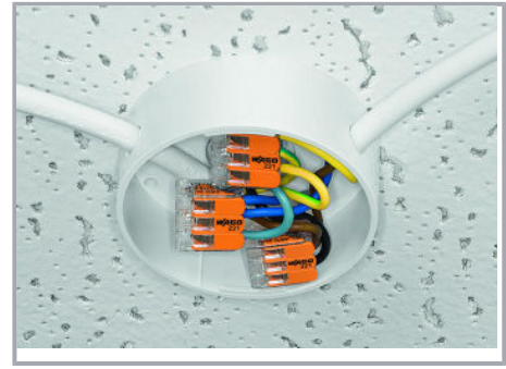
Leuchtenverteilung in Deckenbaldachin
